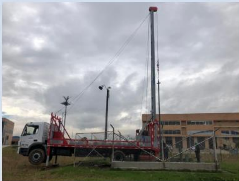
EQUIPO PUMP HOIST N° 2
