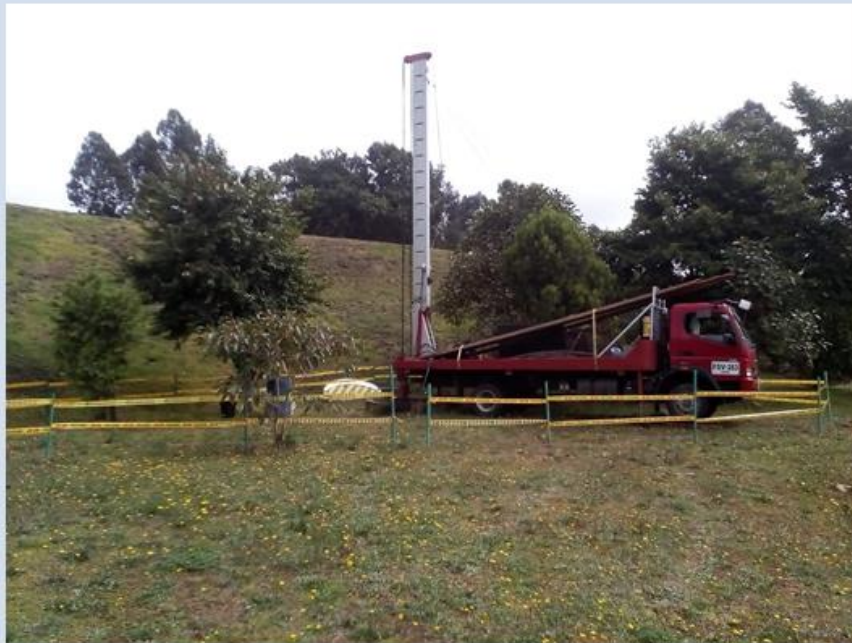
EQUIPO PUMP HOIST N° 1
